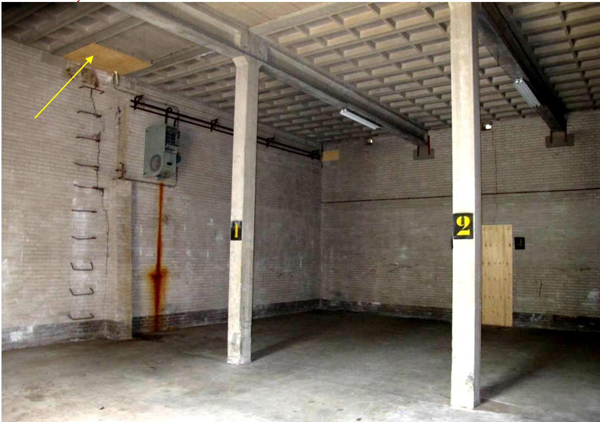
Eén van de hallen van gebouw 8 uit 1953/54 met een constructie bestaande uit betonnen kolommen met betonnen liggers met daarop cassettenplaten van bimsbeton. Midden op het dak staat een lichtstraatachtige opbouw waarin een transportleiding was opgenomen met pijpen voor lozing in elke ruimte (gele pijl) MAB 2011
