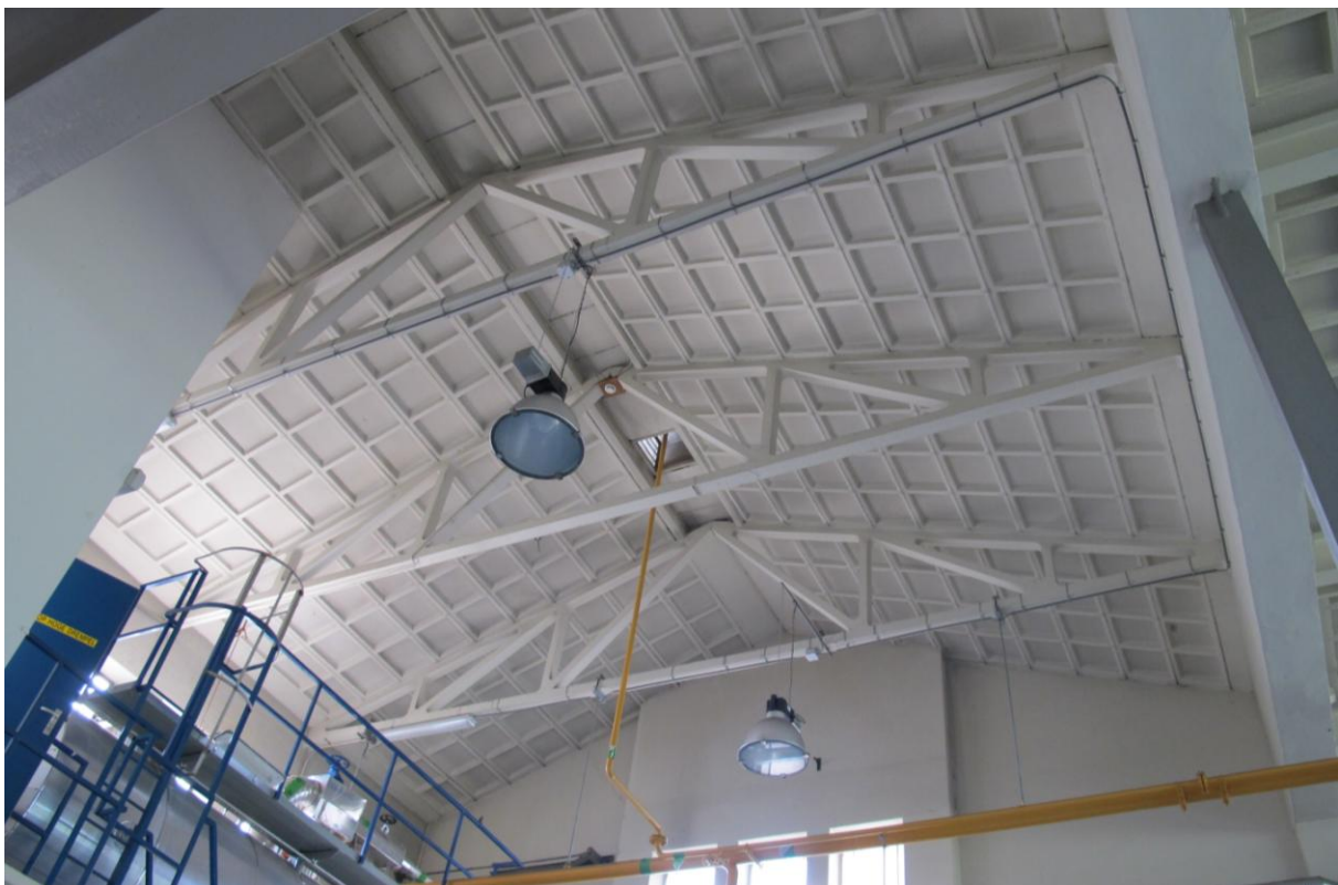
De betonnen kapconstructie van het oudste deel van het ketelhuis (gebouw 26/27) waarvan het zuidelijke deel nog de oorspronkelijke ruimtewerking behouden heeft. MAB 2011
