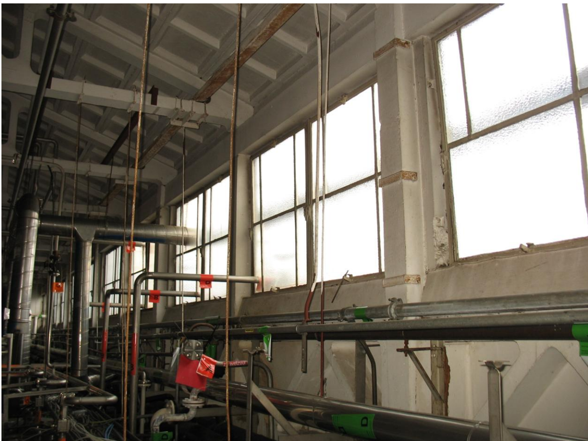
De lichtbeuk met betonnen kolommen en stalen ramen en een betonnen vakwerkligger daaronder van de driebeukige hal (gebouw 36) MAB 2011
