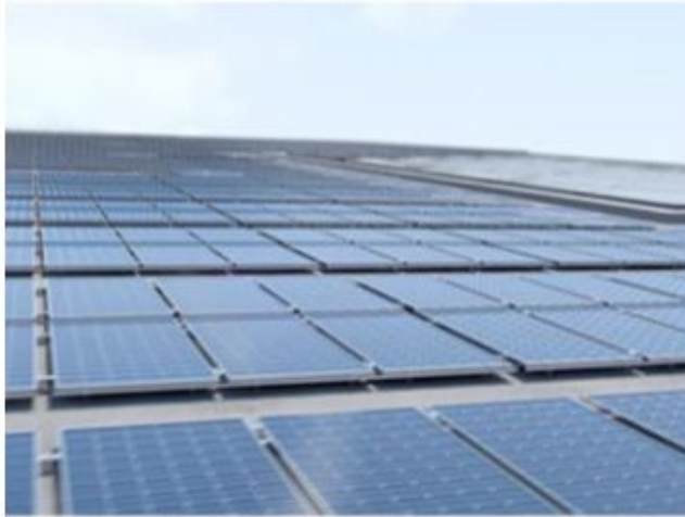
488 Zonnepanelen 95,200 Wp generatie
