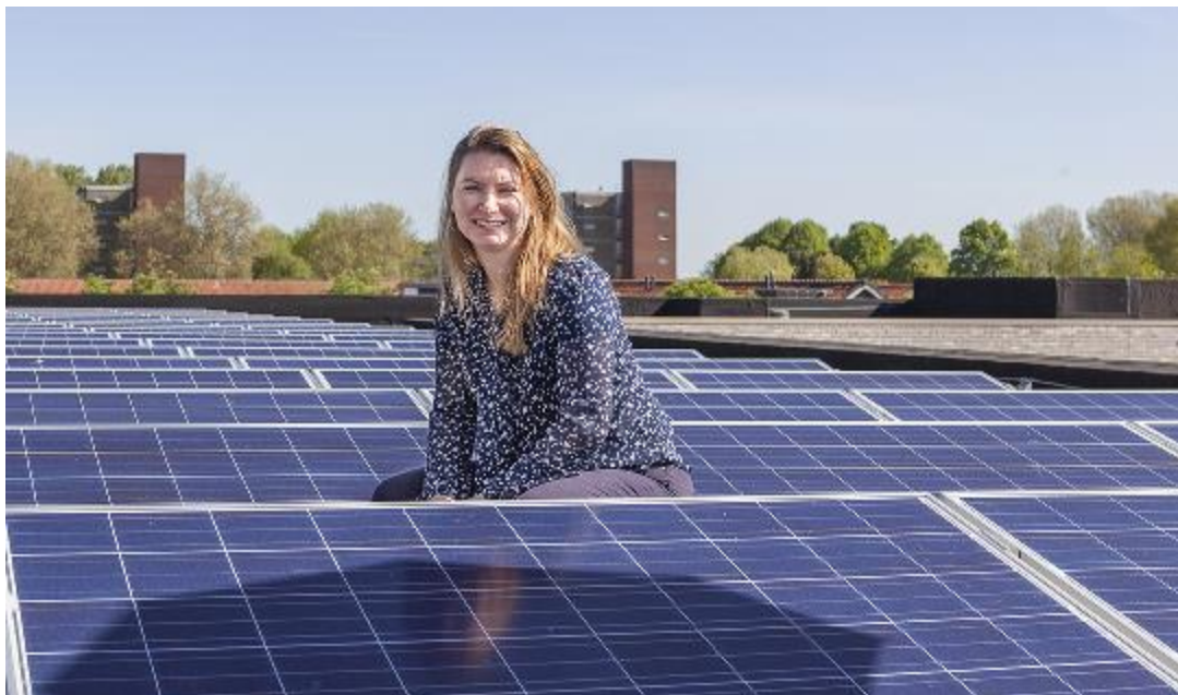
Judith van Nuland tussen de zonnepanelen op het dak van Brede School Noorderlicht die op zonnige dag in mei 214 KWh hebben opgeleverd.
