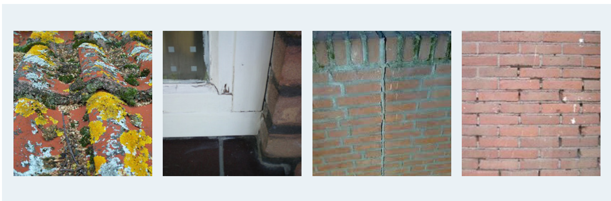
Figuur 3.2: Technische degradatie.
