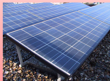
Zonnepanelen op het dak van het Stadskantoor
